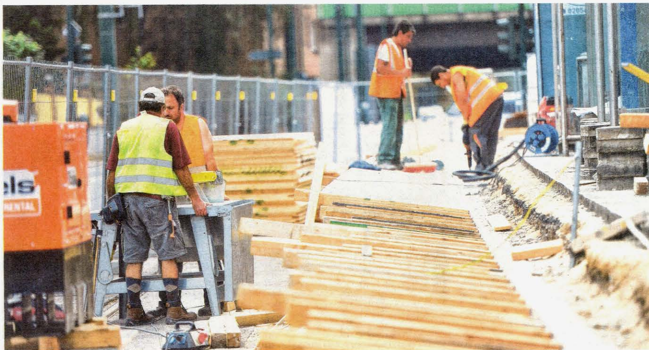
Blick auf die Baustelle an der U-Bahn-Haltestelle Heßlerstraße. Für rund 400.000 Euro werden an fünf Stationen die Bahnsteige erneuert.
