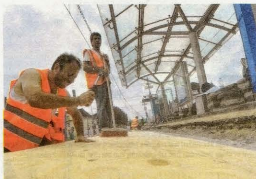
In spätestens sechs Wochen sollen die Bahnsteige fertig sein. FOTO: SEBASTIAN KONOPKA
